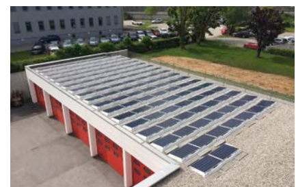
PV-Anlage beim Landesstudio OÖ
